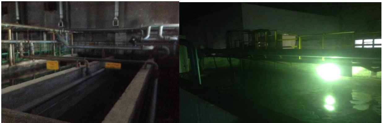
Зураг 29. Хөргөлтийн усыг сэлбэх байгууламжууд
